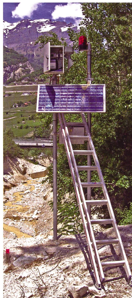
Bild 3. Alarmanlage mit Blinklicht und Sirene auf Sperre 28. Im Hintergrund die Kantonsstrassenbrücke über den Illgraben.
