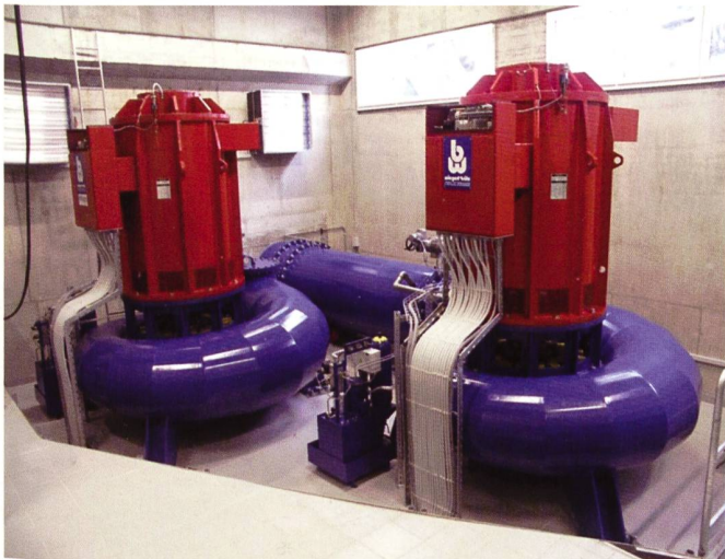
Bild 8. Mit den beiden neu installierten Francis-Spiralturbinen konnte die Leistung von 400 auf 1800 kW erhöht und eine verdreifachte Stromproduktion realisiert werden.
