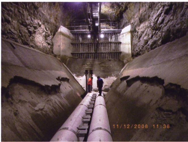
Bild 3. Liegen gebliebener Sand nach erfolgter Spülung und Absenkung des Beckens.
