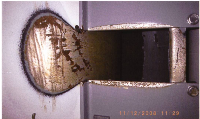
Bild 5. Verschleiss des Korrosionsschutzes am Abzugrohr System HSR.
