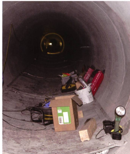
Bild 3. Abwasserwärmanlage Wässerwiesen Winterthur, Abwasserkanal mit Wärmetauscherelementen, September 2009.
