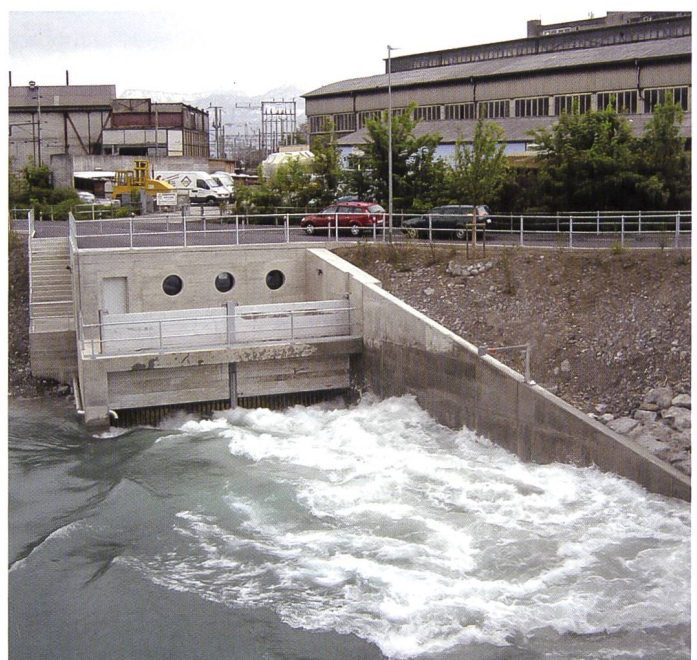
Bild 6. Auslaufbauwerk bei einem Ausfluss aus dem Stollen von knapp 90 m 3 /sec während der ersten Tests (Quelle: IC).
