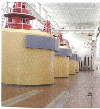
Bild 1. 245 MW installierte Leistung: Maschinensaal der Centrale Sils.
