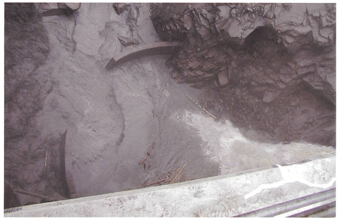
Bild 11. Bruch des Umleitdammes anlässlich einer Spülung im Jahr 1997.
