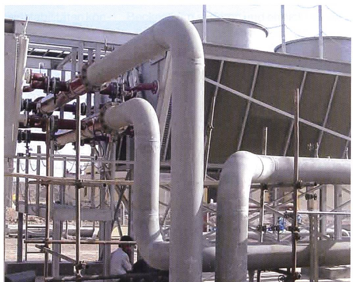
Bild 10. Verrohrung Assalouyeh Power Plant.
