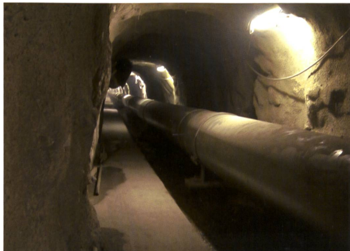
Bild 2. Der 738 Meter lange Stollen mit eingebauter Druckleitung.
