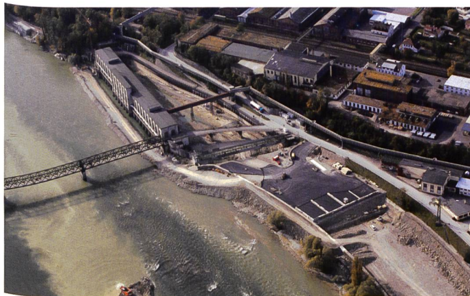
Bild 13. Vor dem Rückbau des alten Kraftwerks musste ein Fangedamm und ein Sortierplatz für die Abbruchmaterialien erstellt werden.
