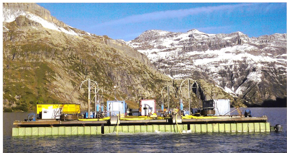
Bild 4. Die Pontons beim Transport des Fassungsbauwerkes an den Bestimmungsort, angetrieben von einfachen Aussenbordmotoren. Die grauen Stahlgerüste sorgten für den Seilnachschub und die Seilführung; links sind die gelben Luftkompressoren zu erkennen (Foto: Ndd).
