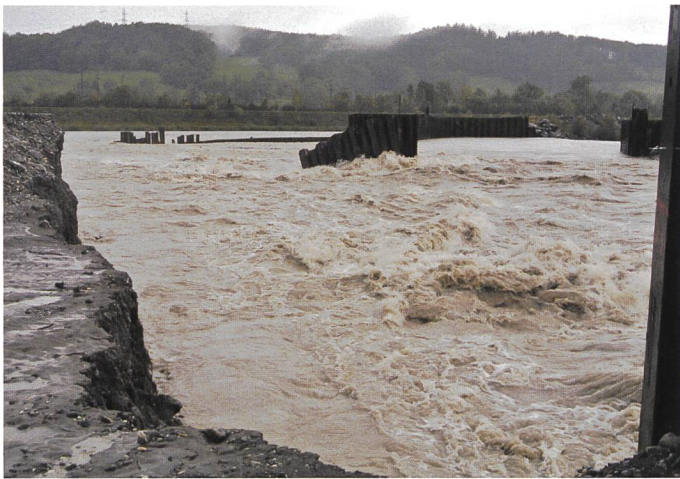
Bild 5. Hochwasserereignis der Ill mit Dammbbruch und mit verheerenden Schäden an der Baustelle, Okt. 2012.
