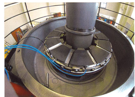
Bild 3. Polypad™-Lager im Kraftwerk Rempen.
