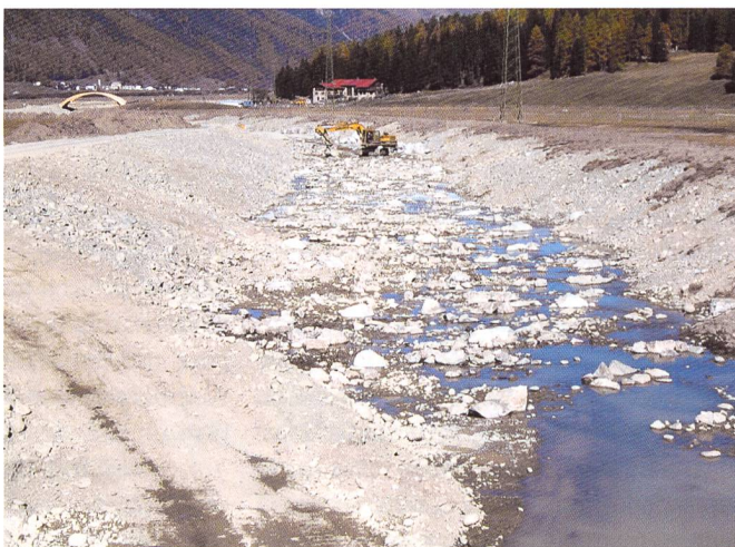
Bild 10. Resultat nach harter Arbeit: Der Gebirgsfluss Flaz hat einen neuen, naturnahen Flusslauf.
