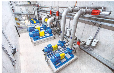
Bild 4. Pumpenraum mit sieben drehzahlregulierten Kreiselpumpen.
