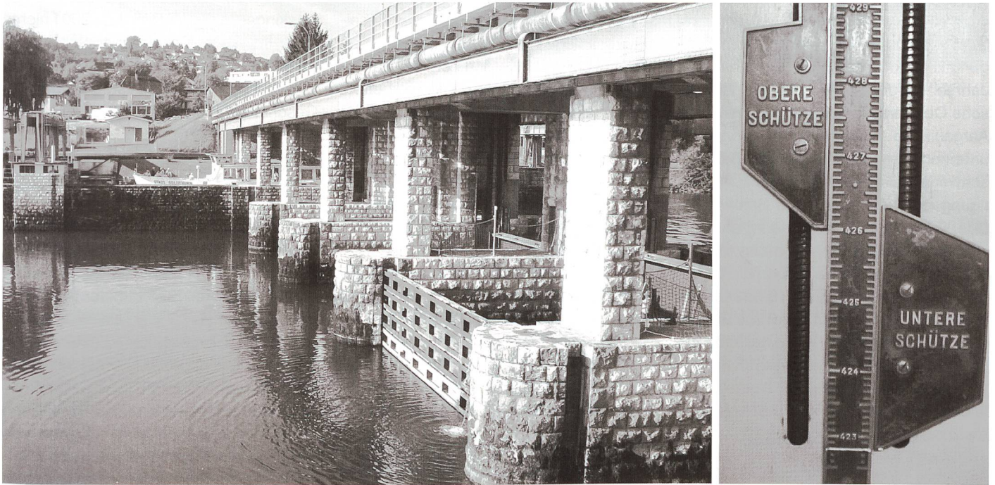
Bild 16a/b. Wehr Port, Kernstück der JGK zur Regulierung des Abfluss aus dem Bielersee.
