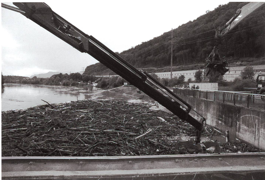
Bild 18. Geschwemmseleentnahme beim Kraftwerk Ruppoldingen im Juli 2014.
