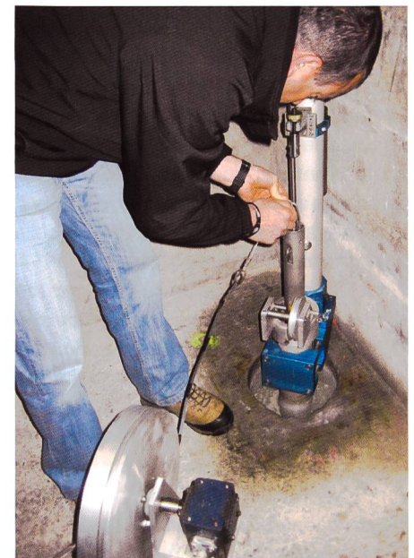
Figura 3. Lettura degli strumenti di controllo nello sbarramento.
