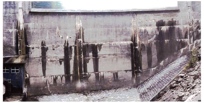
Bild 2. Die Alkali-Aggregat-Reaktion führt insbesondere bei Staudämmen zu einer Rissbildung. Diese ist im fortgeschrittenen Stadium als Rissnetz an der Oberfläche sichtbar. (Foto: Johannes Maier).
