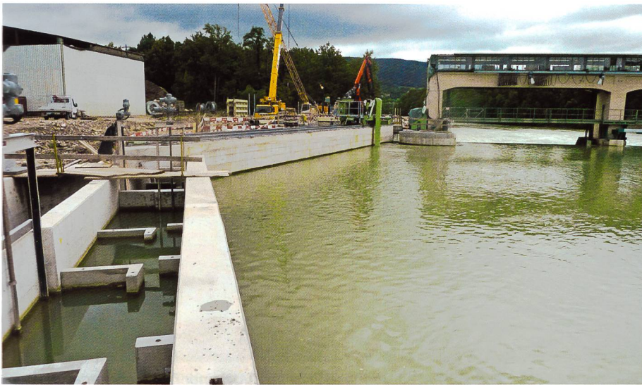
Bild 8. Neben naturnahen Umgehungsgerinnen können den Fischen auch technische Anlagen – wie dieser 2014 neu erstellte Schlitzpass beim Kraftwerk Rüchlig in Aarau – als Wanderhilfen dienen (Bild: Daniel Bernet, Fischereinspektorat, Kanton Bern).
