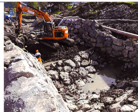
Bild 10. Kolkwanne, Prinzip und Bauausführung, Fließrichtung im Foto von rechts nach links.
