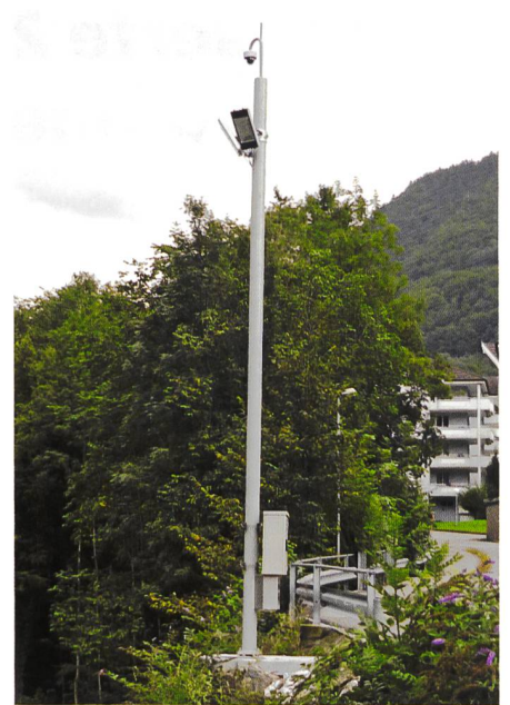
Bild 5. Beleuchtung und Elektroinstallationen.
