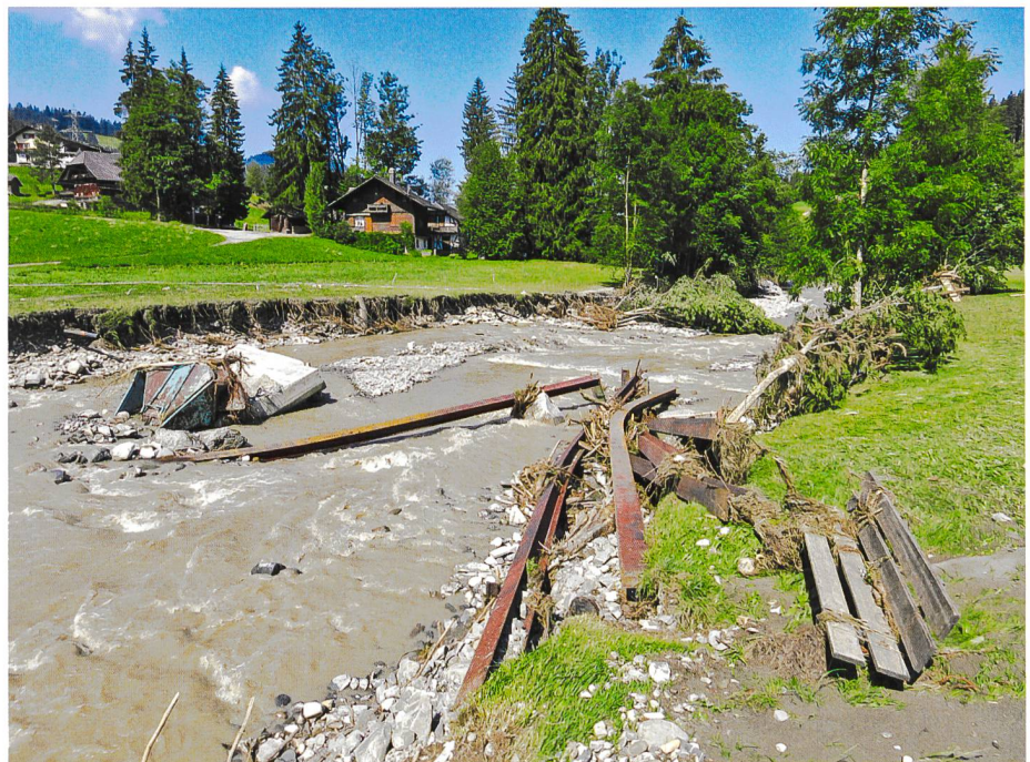
Bild 1. Weggeschwemmte Büetschlibrücke bei Bumbach Dorf in der Gemeinde Schangnau (Foto: Geotest AG).
