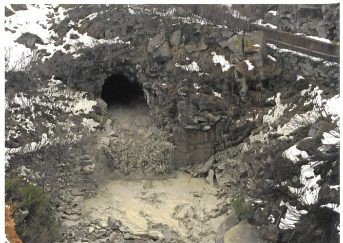
Bild 4b. Ausfluss aus dem Grundablass des Räterichsbodensees, November 2014 (Bild: Steffen Schweizer).
