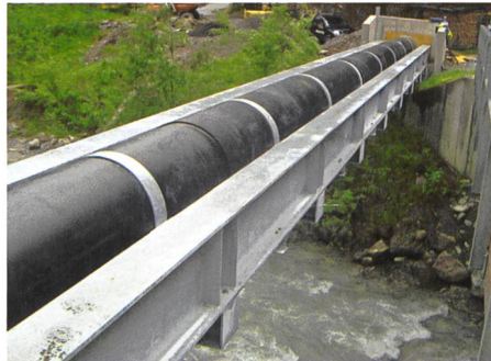
Bild 20. Rohrbrücke mit isolierter Druckleitung DN 600 (Mai 2015).
