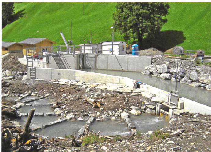
Bild 5. Blick auf den Fischpass (Beckenpass Raugerinne) der Fassung Fermelbach (Aug. 2016).
