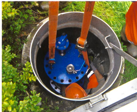
Bild 21. Inspektionsöffnung mit Entlüftungsventil Hochpunkt Düker (Mai 2016).
