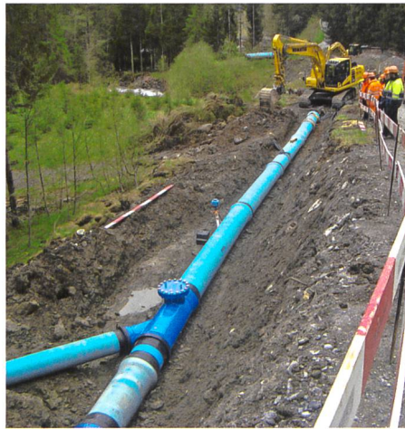
Bild 19. Druckleitung DN600 mit Vereinigung und Inspektionsöffnung (April 2015).
