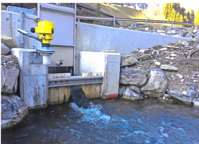
Bild 6. Blick (gegen die Fließrichtung) auf das Einlaufbauwerk des Umgehungsgerinnes mit Restwasserabgabe. Die Pegelmessung ist oben links ersichtlich, die rote Markierung in der Mitte des Bildes stellt die optische Überprüfung der Restwassermenge dar (März 2017).
