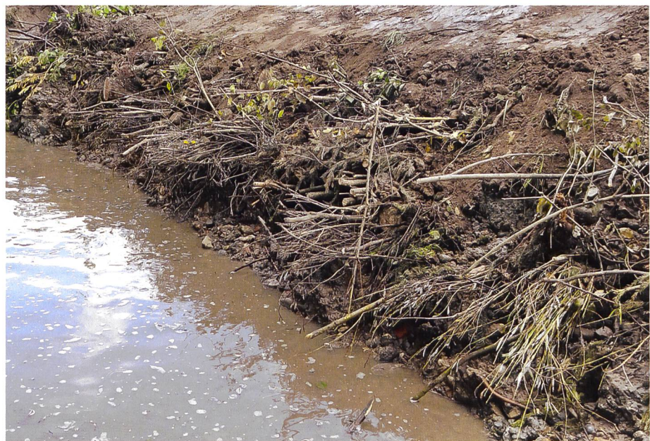
Bild 6. Die Böschung wird durch die vorstehenden Enden der Buschlagen lückenlos geschützt. Bis die Äste verrotten sind, hat die Durchwurzelung der Weiden die Festigung der Böschung übernommen.
