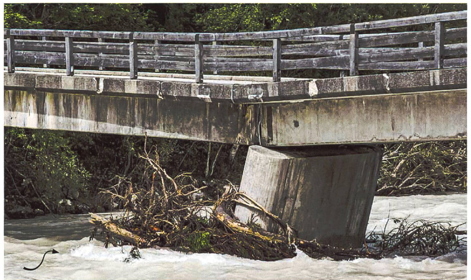
Bild 1. Verklausung an einem Brückenpfeiler und strukturelle Versagenswahrscheinlichkeit aufgrund von Kolk (Foto: bridgemastersinc.com ).
