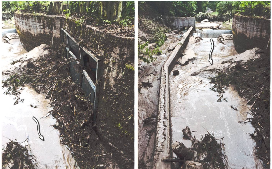
Bild 3. Links: Rechenverklausung beim Einlauf in den Stollen. Rechts: Auflandungen im Verzweigungsbauwerk (mod. nach oeko-b Fotodokumentation, 2015).
