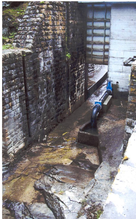
WF Puntalta, Tafelschütz Grundablass und Dotiereinrichtung.
