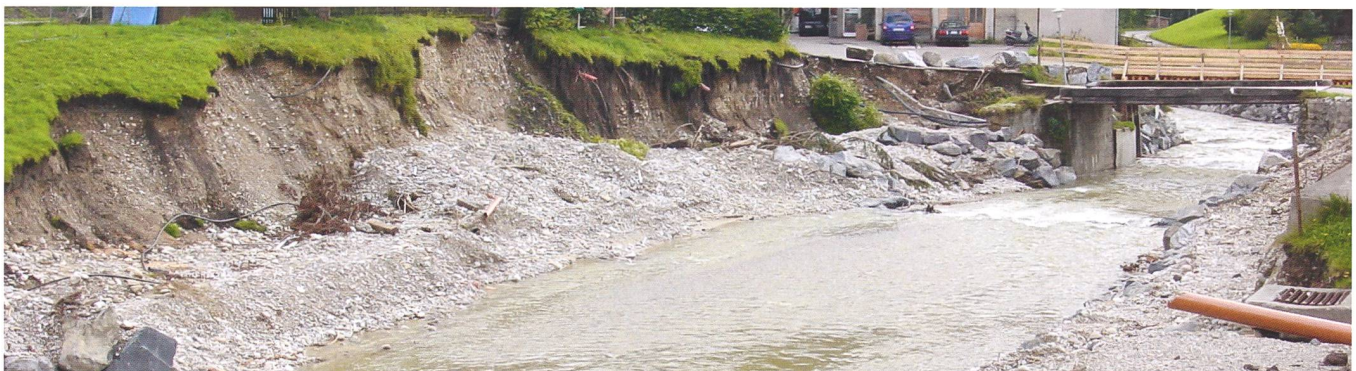
Figure 1: Erosion des berges de la Trueb pendant les crues de 2005. Photo: Flussbau AG SAH.
