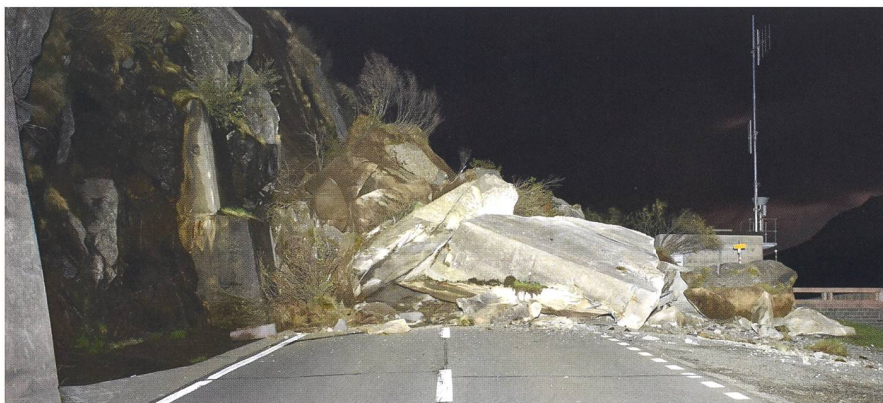
Bild 6: Am 11. Juni ging auf dem Lukmanierpass ein Felssturz nieder und blockierte die Passstrasse auf der Nordseite der Galerie Scopi auf einer Länge von 30 m. (Foto: Kantonspolizei Graubünden).
