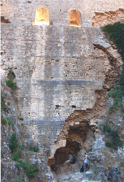
Bild 8: Luftseite der Staumauer mit den Hochwasserüberläufen (oben). Über den Resten des Grundablassgewölbes grosse Mauerausbrüche infolge hydrodynamischer Vorgänge im Grundablass. Oben rechts der Bogenrest der ehemaligen Aquäduktbrücke.
