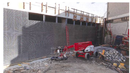
Bild 7: Das Limmat-Kraftwerk in Dietikon (ZH) verfügt seit dem vergangenen Jahr über den grössten Horizontalrechen in der Schweiz mit einer Rechenfläche von über 200 m 2 und einem Stababstand von 20 mm. Das Foto wurde im August 2019 aufgenommen, kurz vor der Inbetriebnahme des Kraftwerks. Der Bypass-eingang befindet sich rechts beim Baugerüst (Foto: Julian Meister/VAW).
