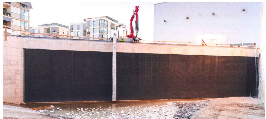
Bild 6: Horizontalreechen HKW vor der Kanalflutung (Foto: EKZ).
