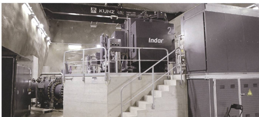
Bild 1: Maschinenraum des Kleinwasserkraftwerks in Oberwald: Die Turbinen mit 2 x 7,5 MW Leistung sind auf die Maximalproduktion im Sommer ausgelegt. Zum Vergleich: Die fünf Windräder, die im Herbst 2020 auf dem Gotthard in Betrieb genommen wurden, haben eine Nennleistung von 5 x 2,35 MW. Foto: FMV.
