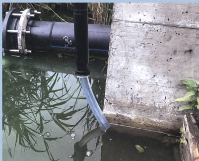
Belüftungsrohr der Hebersteuerung, im Hintergrund Tiefenwasserableitung.
