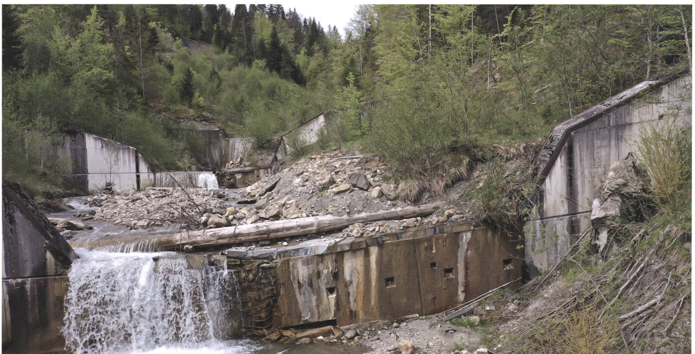
Detailansicht der starken Beschädigungen an der Sperre 33. Die Sperre ist stark verkippt und weist grosse Betonabplatzungen auf. Foto: Jürg Speerli.
