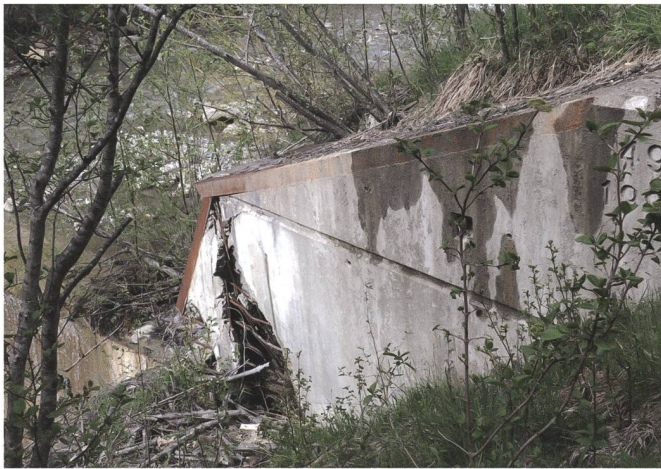
Starke Beschädigungen an der Sperre 49. Der linke Sperrenflügel wurde durch die Rutschung ins Unterwasser weggedrückt. Foto: Jürg Speerli.
