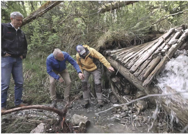
Andreas Stettler besichtigt mit Bernhard Perren und René Lauper die beschädigten Wildbachverbauungen im Meierisli-Graben. Foto: SWV.
