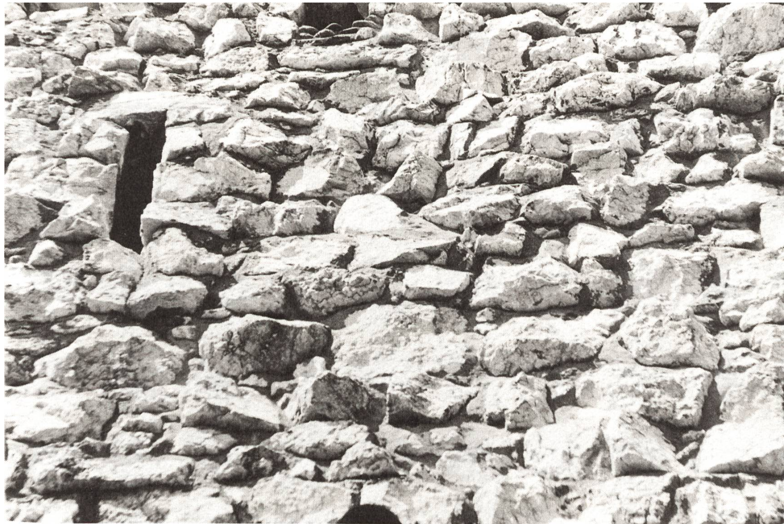
8 Mauerwerk der Südwand des Bergfrieds (zirka 1200); die Bruchsteine stammten wohl aus dem unmittelbar östlich davon ausgehobenen Halsgraben der ersten Burg.
