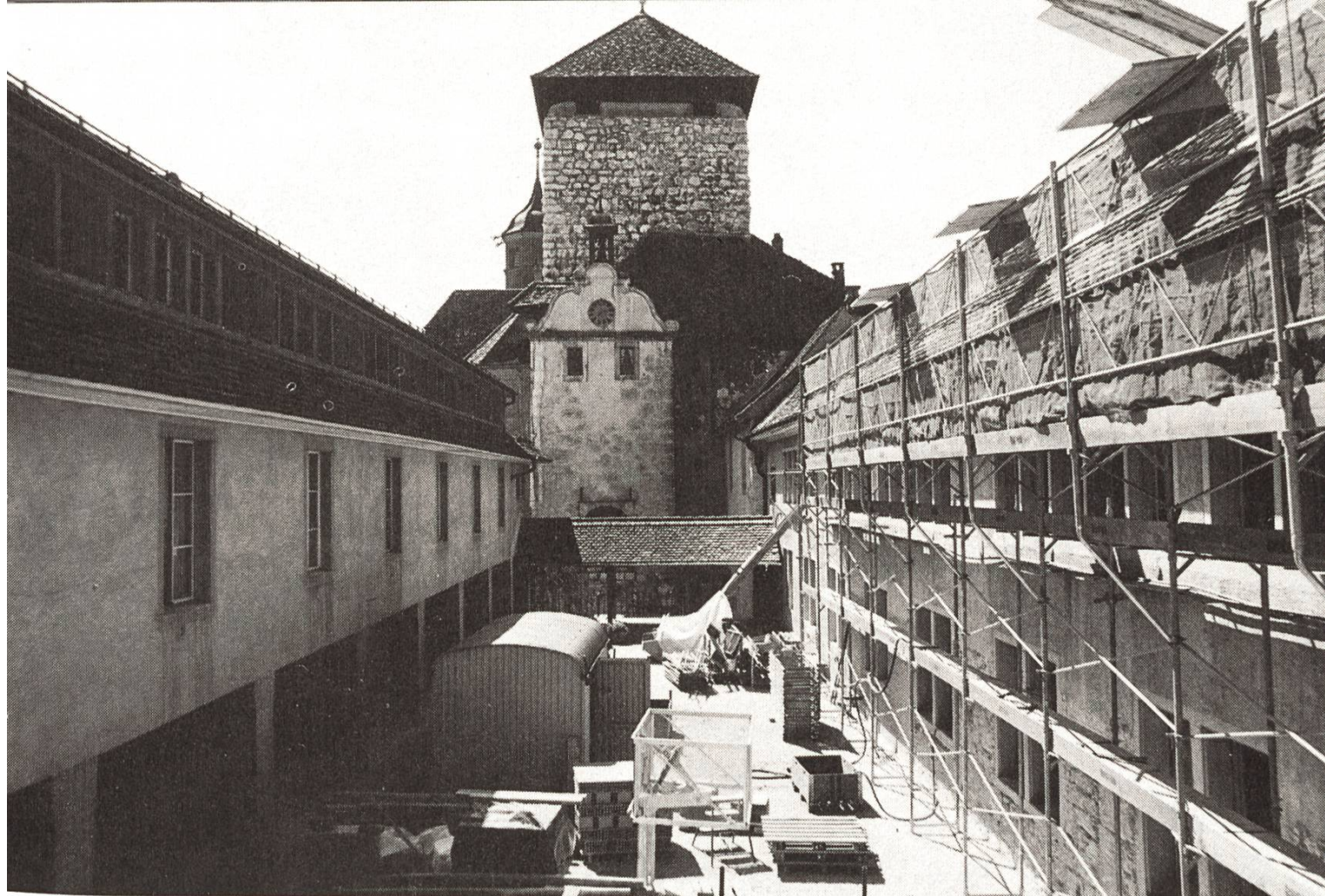
10 Blick auf den ehemaligen Paradeplatz der Festungsgarnison mit den Kasernen links und rechts davon; im Hintergrund der ältere Schlossteil mit Kapelle, «Harzer» und «Schnecken».
