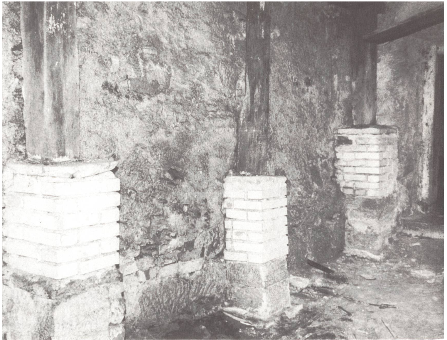
Die Auflager der Tragbalken waren zum Teil abgefault und mussten unterstützt werden.
