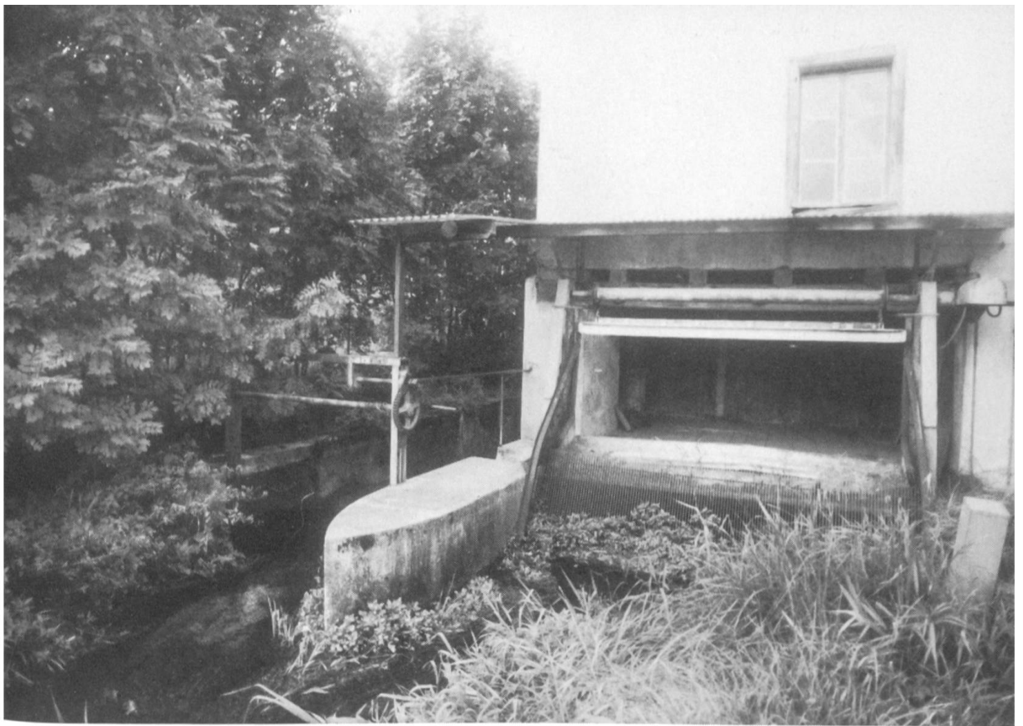
Turbineneinlauf, Leerlauf, Alberswil.
