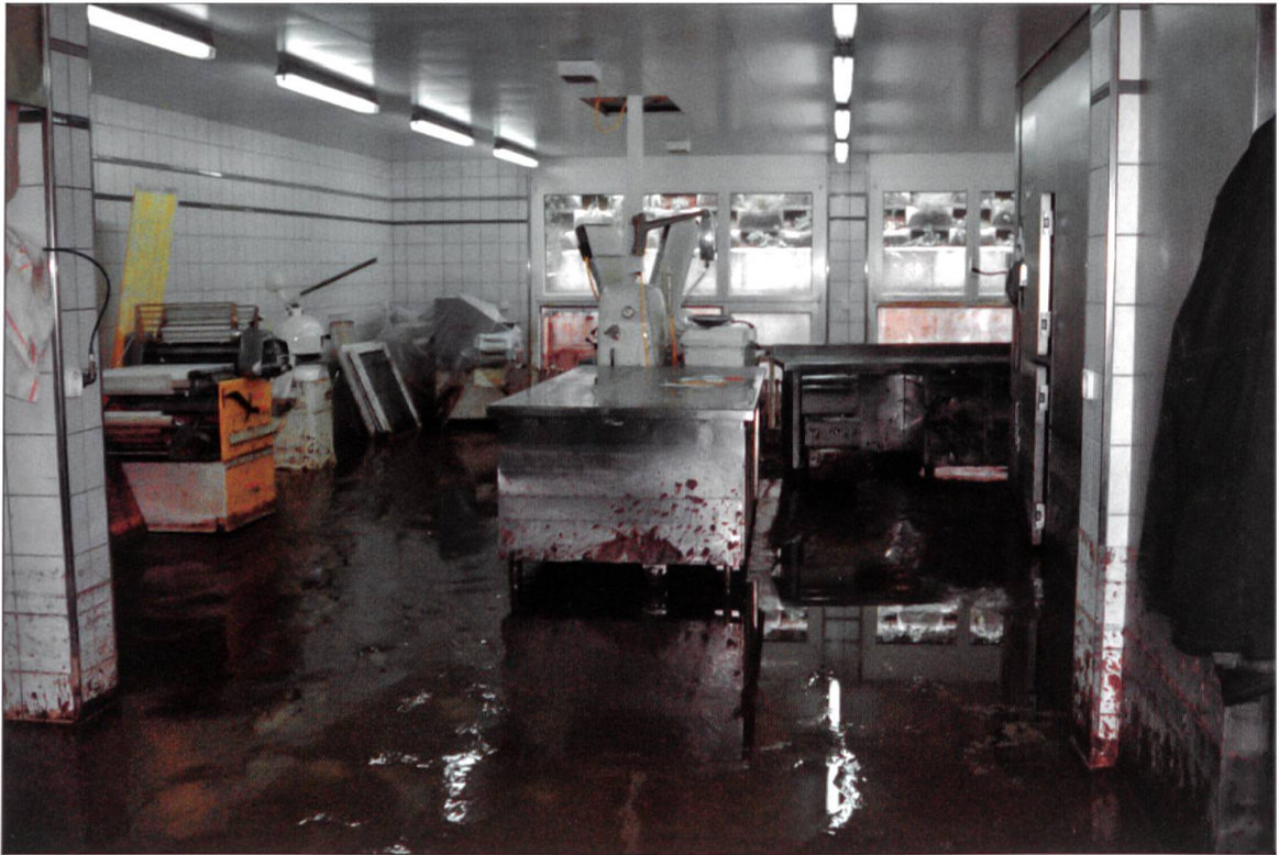
Ansicht des Produktionsraumes in der Bäckerei, wo das Wasser 1992 einen Höchststand von einem Meter erreichte. Durch den hohen Wasserstand wurden alle Maschinen, die Kühl- und Tiefkühlräume sowie der Unterlagsboden für drei Monate unbrauchbar (Revisionen und Austrocknung).
