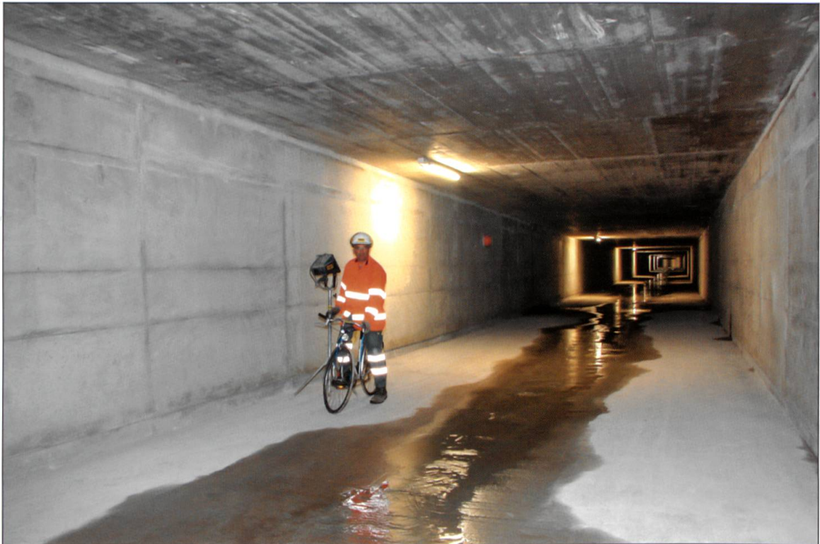
Blick in den Hochwasserentlastungskanal. Maximal können hier 75 Kubikmeter Wasser pro Sekunde fließen.
