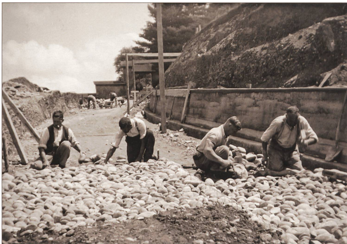
Die beiden Bilder von Bauarbeiten an der Schlossstrasse Willisau dokumentieren die rasante Entwicklung im Baugewerbe.
