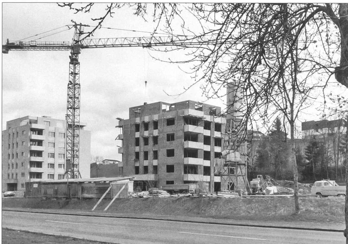
Auf dem Schlüsselacher in Willisau erstellte die Wilimmo AG 1976 ein markantes Mehrfamilienhaus.
