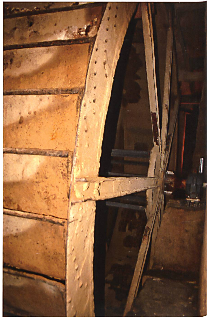
Oberschlächtiges Wasserrad der Mühle Berkenbühl. Aussendurchmesser 4.50 Meter.
