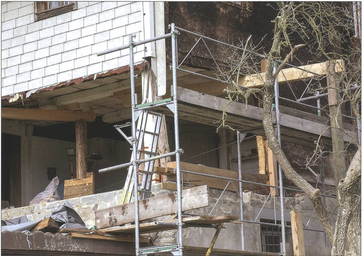
Grosse Restaurationsarbeiten im Frühling 2005. Kellermauern, Kellerdecke, Küchenwände und Küchenboden mussten dauerhaft statisch gesichert und mit viel Titan und Stahl, Beton und Mörtel, Holz und Steinen saniert werden.
