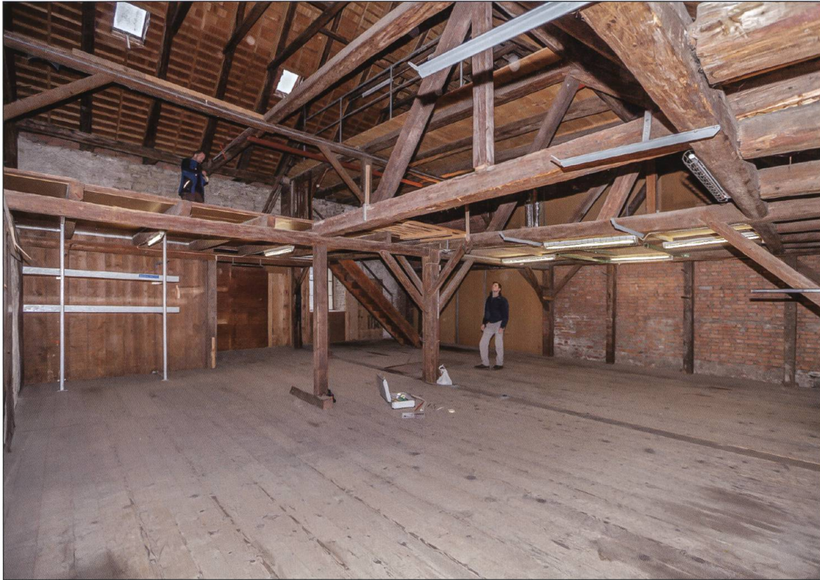
Abb. 6 Blick in die Scheune Pfistergasse 42 während der dendrochronologischen Beprobung der Ständerkonstruktion. Ansicht von Osten. Foto Cecilie Gut
