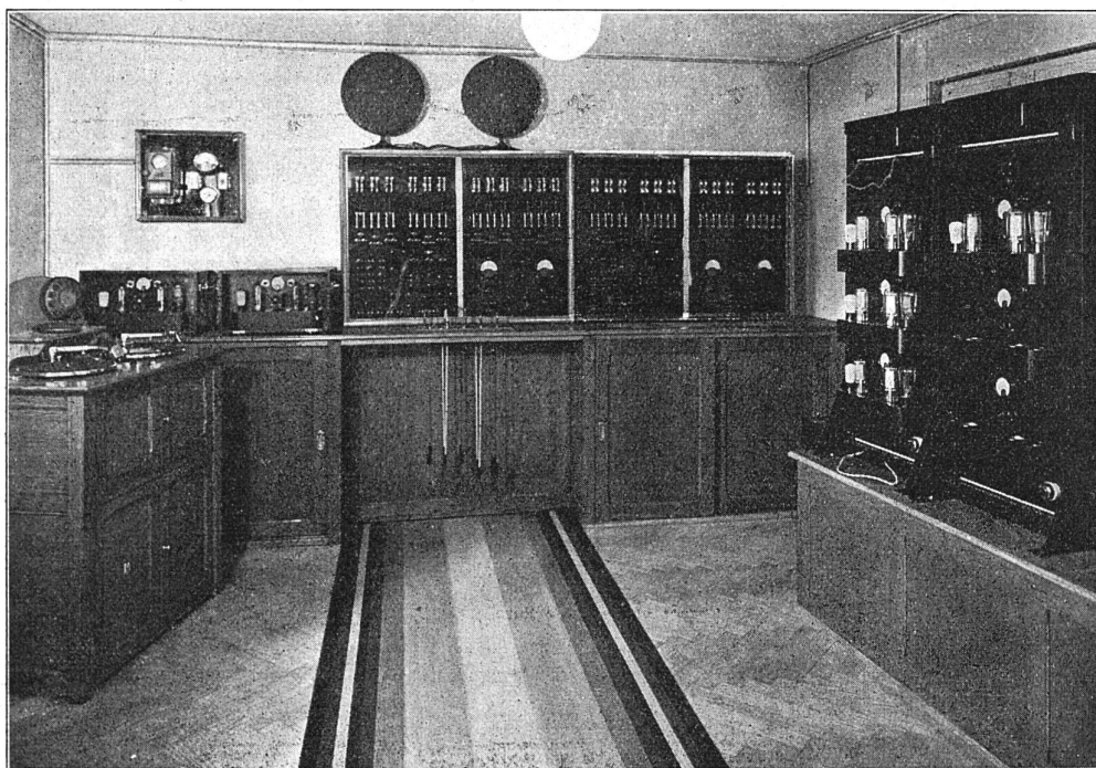
Verstärkerzentrale mit Verteilertableau und Mess-Instrumenten, von wo aus die Verteilungen zu den Abonnenten gehen
