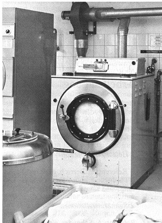
Die Wäscherei des Altersheims «Sandbühl» in Schlieren ist mit je einem 12- und einem 18-kg-Gaswaschautomaten ausgerüstet. Links daneben der Gastumbler.
