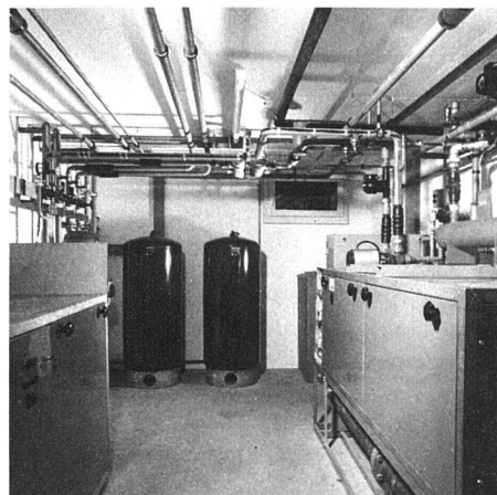
Blick in die Heizzentrale mit Wärmepumpen und Expansionsgefässen
