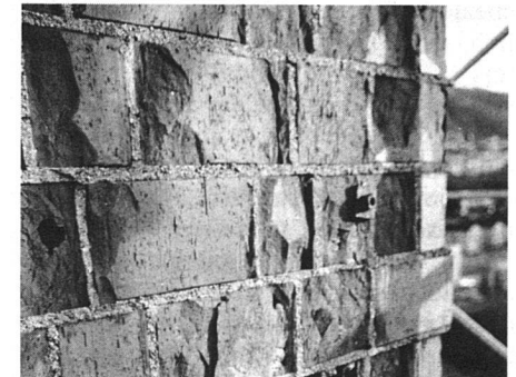
Durch mangelhafte Verarbeitung abgefrorenes Mauerwerk (unten)
