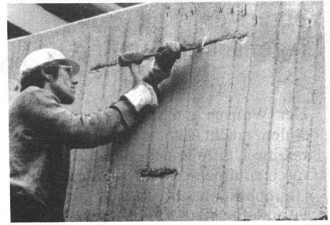
Freilegen von korrodiertem Bewehrungsstahl.
